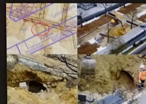
2025. Rue du Commandant René Mouchotte, les travaux pour la création de la promenade plantée devront traiter plusieurs anciennes galeries. SHAP, SHAP
